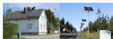
(a) Panel sel surya digunakan (a) di rumah, (b) lampu penerangan jalan
