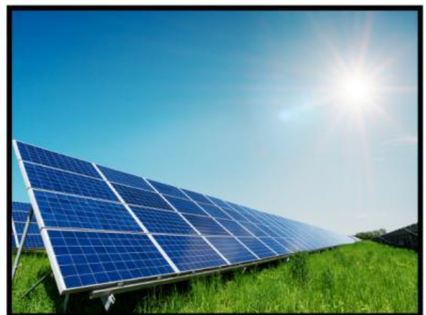
Panel Surya pada PLTS
