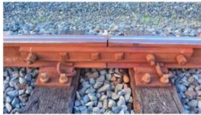
Gambar .Celah pada sambungan rel kereta api
