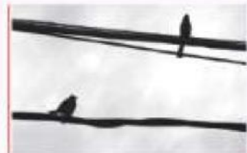
Gambar 1.f. burung hinggap di kabel listrik
