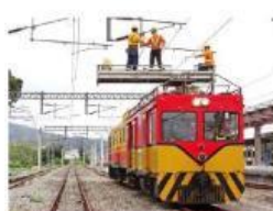
台鐵高壓電線
