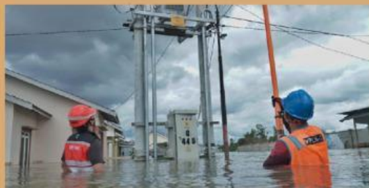
Gambar 2. Pemadaman Listrik Saat Terjadi Bencana Banjir
