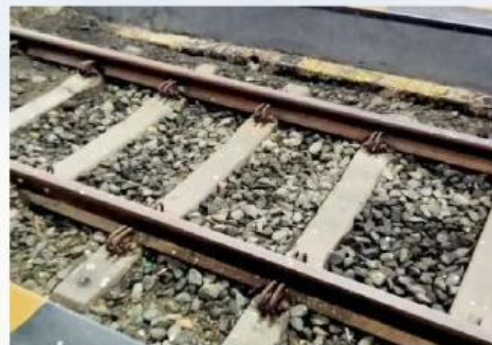
Celah pada rel kereta Sumber: Dokumen Pribadi
