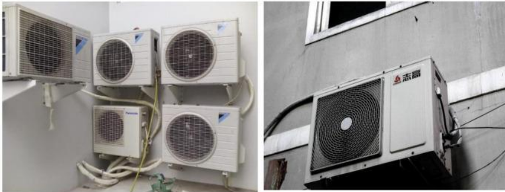
Gambar 5.5 Kompresor dan kondensor AC mengeluarkan hawa panas
