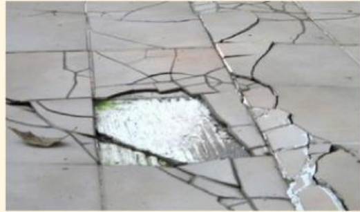
Gambar 2.2 Lantai keramik retak
