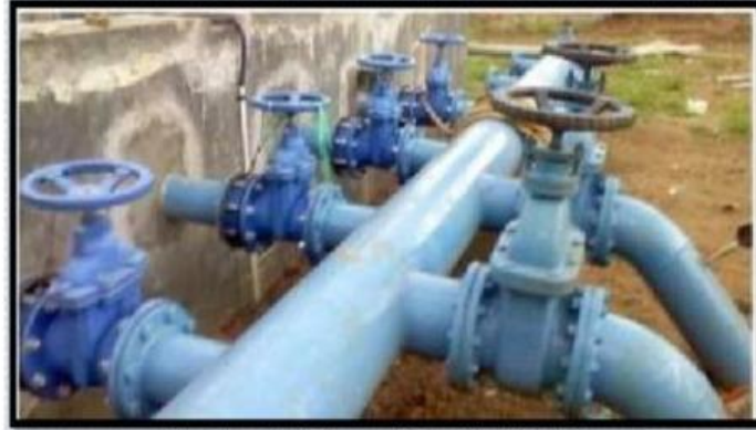
Gambar 1. Saluran Pipa Air PDAM
