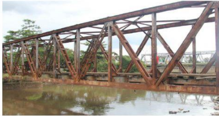
Gambar 4. Peristiwa korosi pada jembatan
