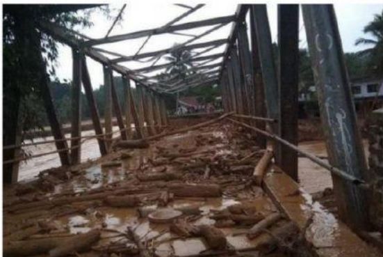
Luapan air sungai merusak jembatan
