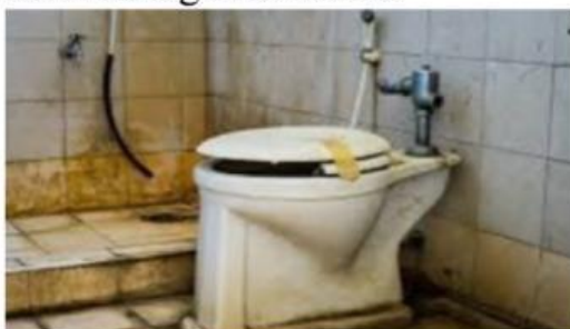
Gambar 2. Kerak Membandel pada Toilet
