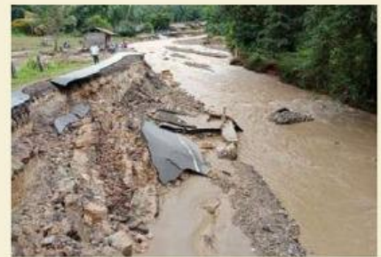
Jalan Rusak akibat banjir
