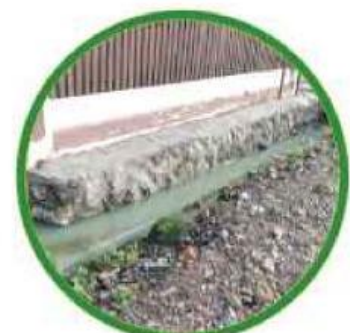
Gambar 3. Genangan Air limbah di selokan Sumber: dokumentasi pribadi
