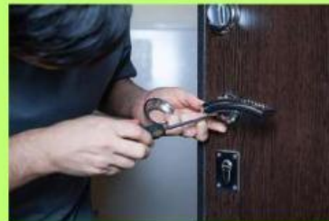
Gambar 6. Pintu kayu sulit dibuka (sumber: Onassis Hardware)
