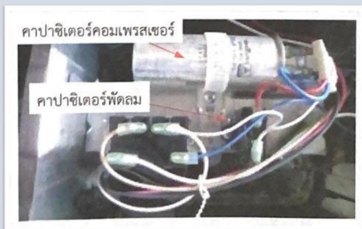
คาปาซิเตอร์คอมเพรสเซอร์และพัดลม
