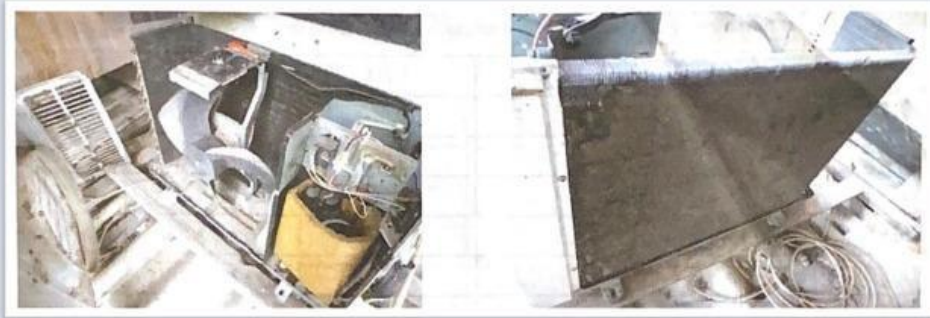
ชุดคอยล์ร้อนของเครื่องปรับอากาศ
