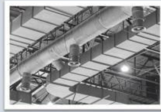
ท้อส่งลม
