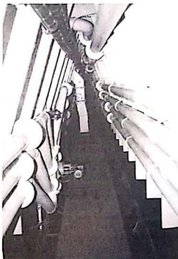
Fig 856 Túnel con las tuberías de aire de las válvulas de distribución a las bodegas.
