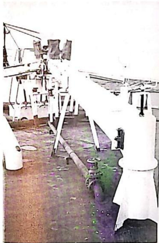
Fig. 843 Canaleta con válvula de seguridad, tapa de registro y tubería sobre cubierta para airear los aerodeslizadores de bodega.
