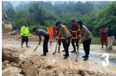
Longsor di Jalan Lintas Riau
