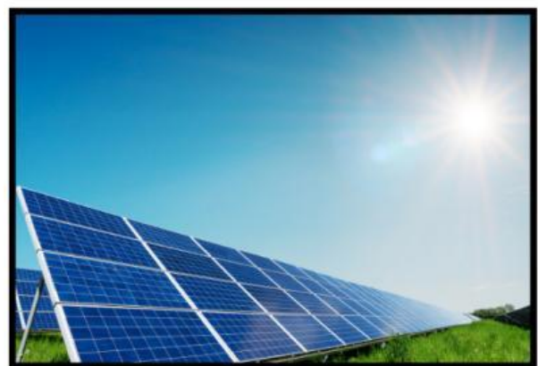
Panel Surya pada PLTS
