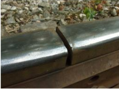
Celah pemuaian pada rel
