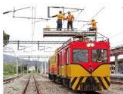
台鐵高壓電線
