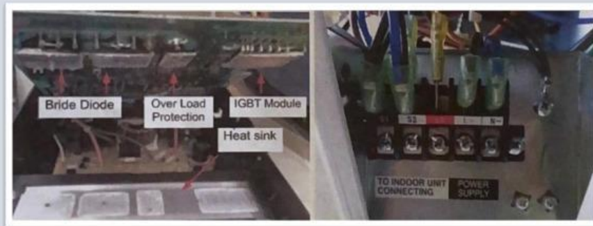
แผ่นวงจรอินเวอร์เตอร์ภาคเพาเวอร์
