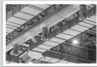
ท่อส่งลม
