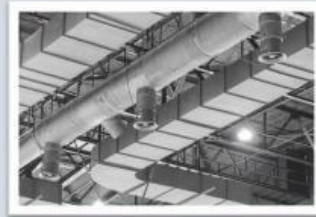
ท่อส่งลม
