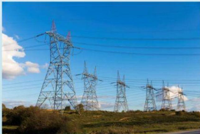
Menara Saluran Udara Tegangan Ekstra Tinggi (SUTET) menyalurkan listrik dari pusat pembangkit listrik menuju lokasi yang jaraknya sangat jauh.
